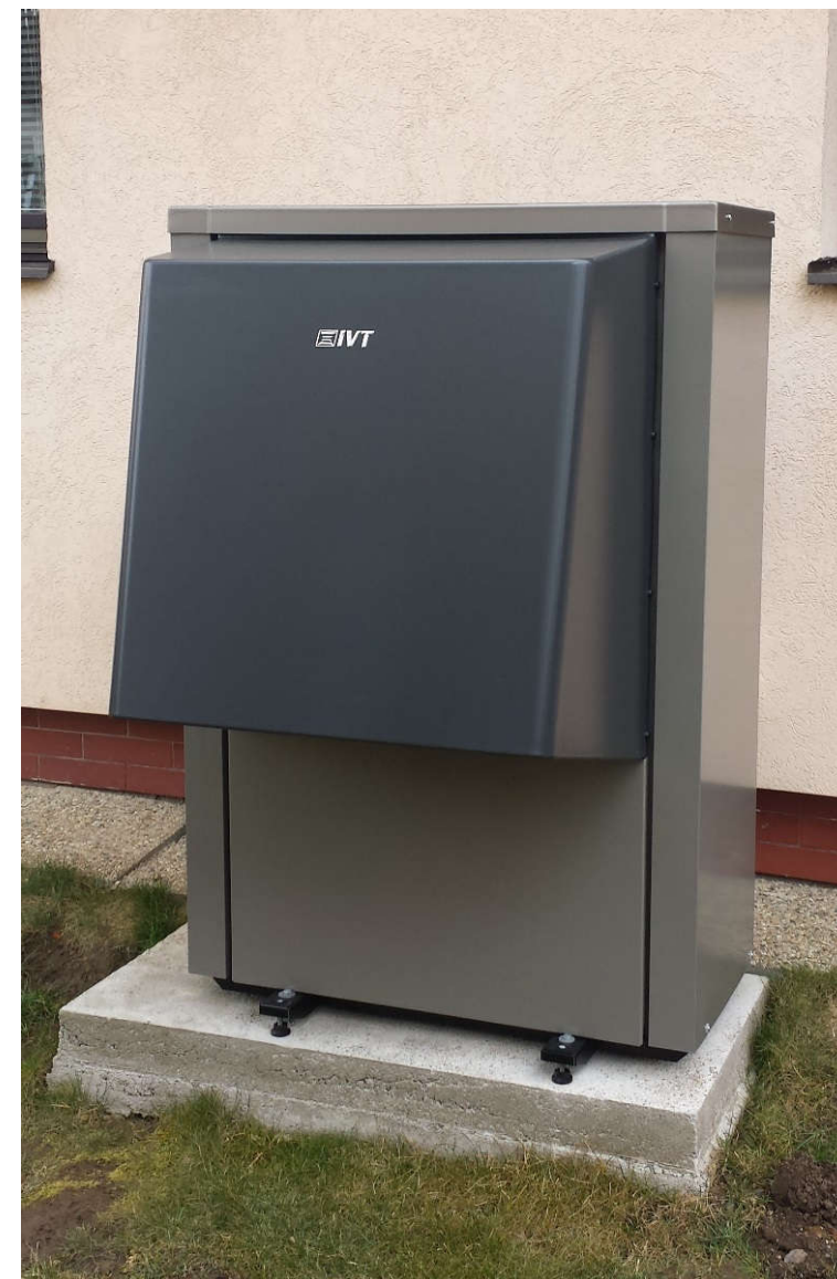
Dodatečně instalovaný protihlukový kryt
